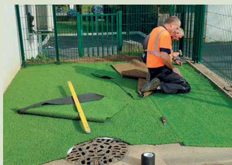
Aménagement d'une aire de jeux à l'école élémentaire d'Ourouspoure, avec la pose d'un revêtement synthétique.
